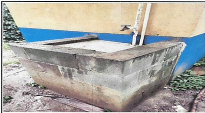
Foto 9: Lavamanos en mal estado
