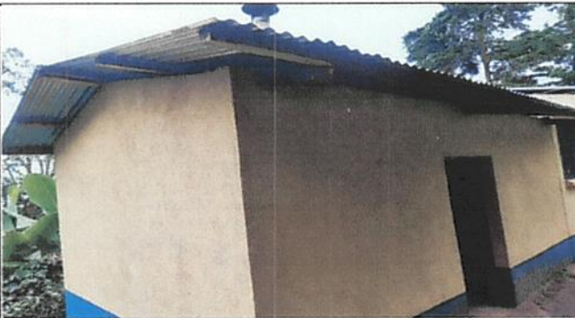
Foto 3: Madera de la cocina en mal estado y las láminas
