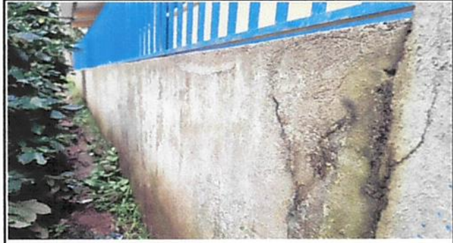
Foto 2: Reforzar muro del corredor, rajado en una esquina con riesgo de hundimiento por la humedad.
